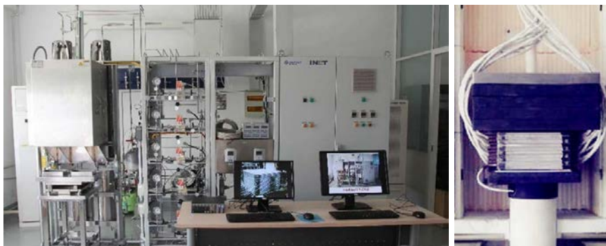
图 7 高温 SOEC 电堆及制氢系统
